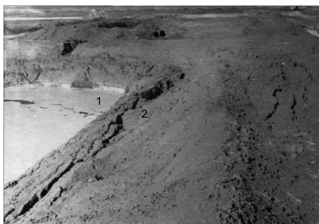
Рис. 5. Вид отсека после взрыва: 1 — вода; 2 — трещины
